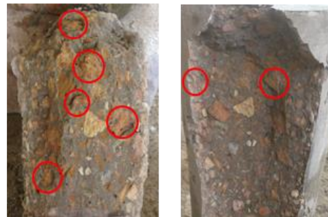
Gambar 6 Kehancuran pada Beton Ringan dengan Agregat dari Tanah Diatomae
